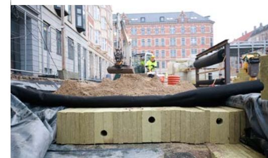
La foto de abajo muestra cómo se instaló Rockflow en la plaza. A diferencia del aislamiento, la lana de roca del sistema Rockflow está especialmente diseñada para absorber y retener agua. Un sistema de tuberías y canales lleva el agua de lluvia a la lana de roca, donde se absorbe rápidamente y se libera lentamente, ya sea al alcantarillado o al suelo circundante.
